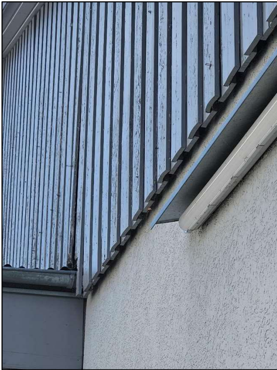
Abbildung 31: Holzfassade an der Westseite des EDEKA-Markts mit Fledermauspotenzial hinter den Brettern.
